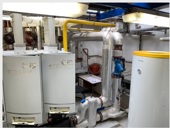
10: Plynová kotelna v Cukrovarnické
