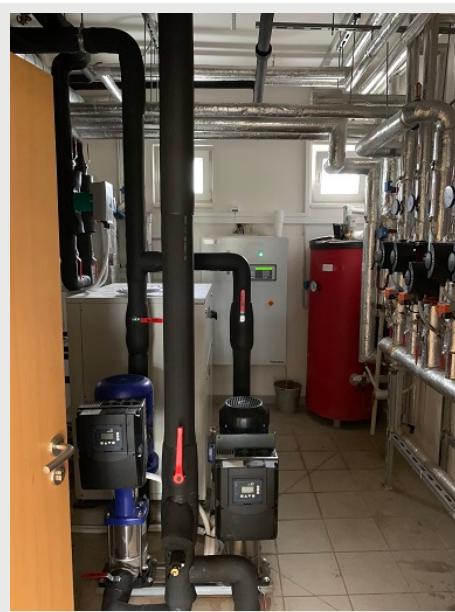
6: Výměník v budově Optiky
